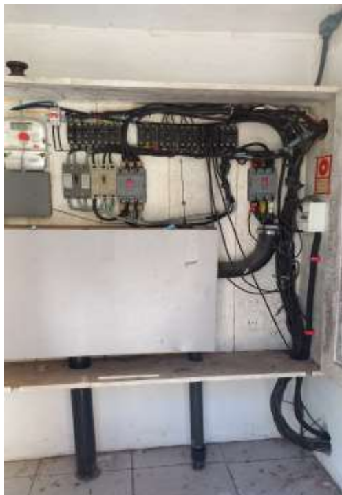
Disjuntores localizados dentro sala medição.
