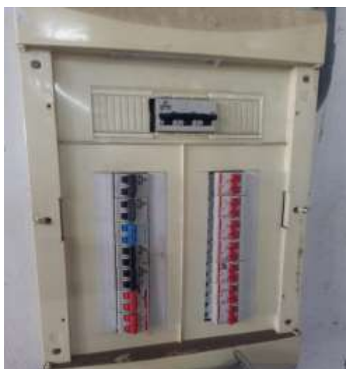
Quadro QT1 existente (Garagem)
