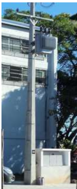
Imagem ilustrativa subestação em poste com medição indireta em mureta de alvenaria.
