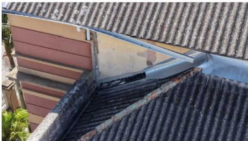
FIGURA 06 - DETALHE RUFO TELHADO DO ALMOXARIFADO.
